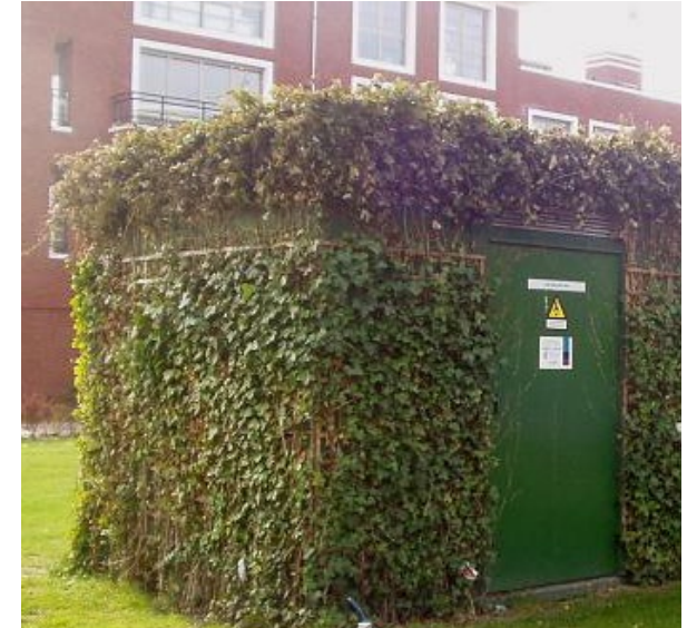
Trafo bekleed met groen
