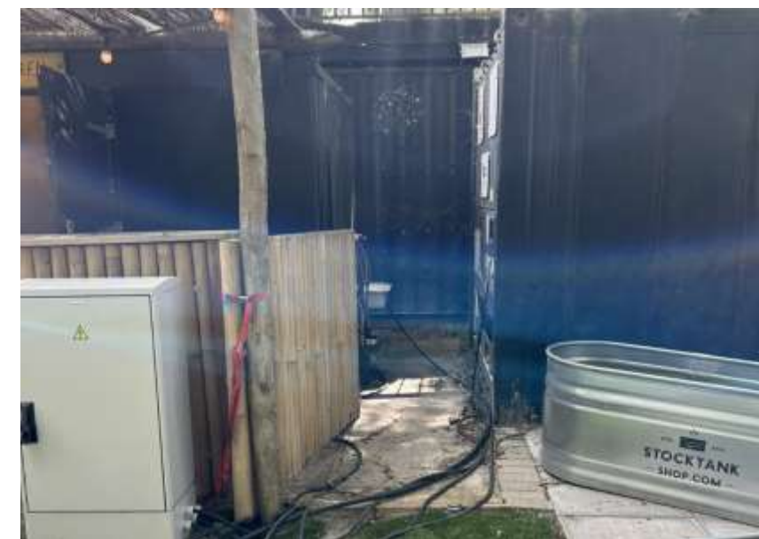
Figuur 6: Achterzijde opslag en kabels
