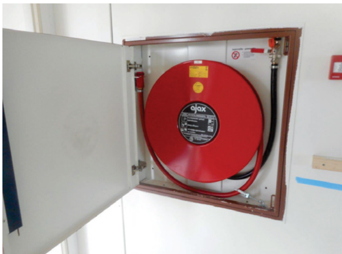
Figuur 5: Brandslanghaspelkast in 'brandwerende' scheidingswand
