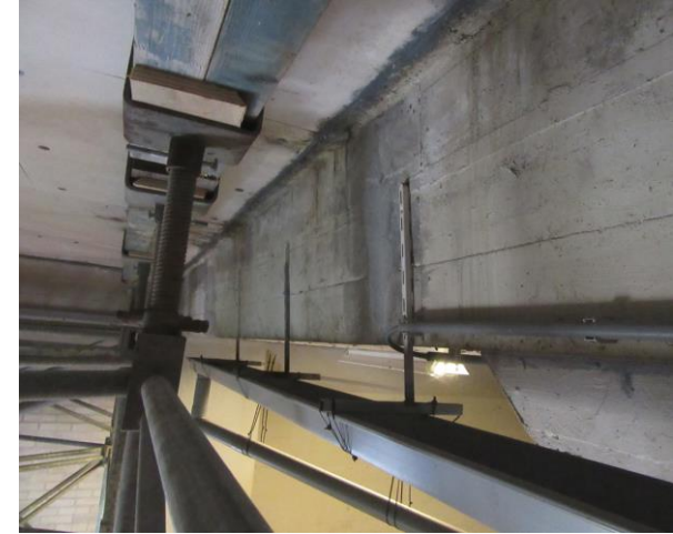
Lekkage binnen de sportschool boven de goot
