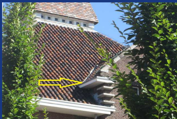
Locatie van de lekkage.
