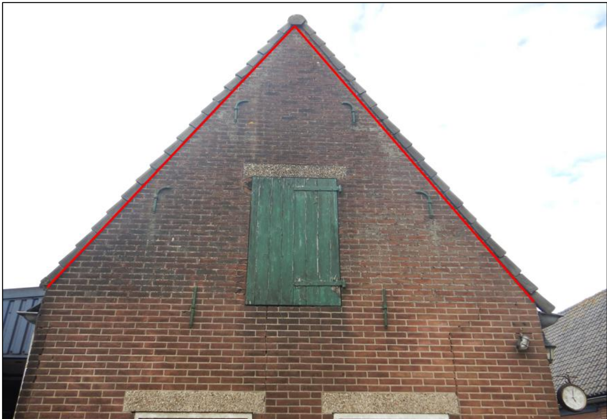
Afb. 6.4.1 Schuur met kierende dakpannen en nok (rode lijn) die toegang geven tot de voor vleermuizen geschikte zolder.
